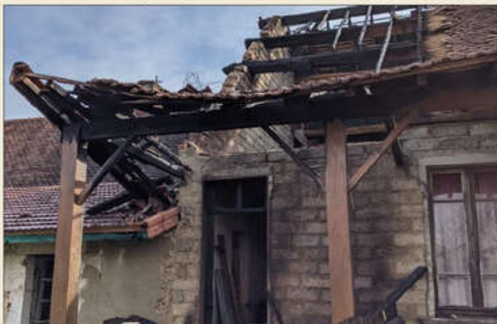
L'incendie s'est déclaré au rez-de-chaussée de cette ancienne habitation inoccupée.
