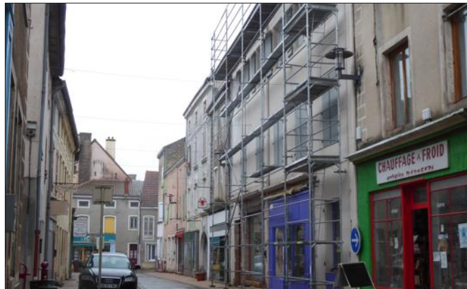
Jusqu'à la fin des travaux, des bacs collectifs sont installés à Cuisery et Ratenelle. Photo JSL/Solange BOCCHIO
